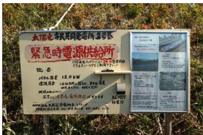
3号機に取り付けた緊急時電源供給所
